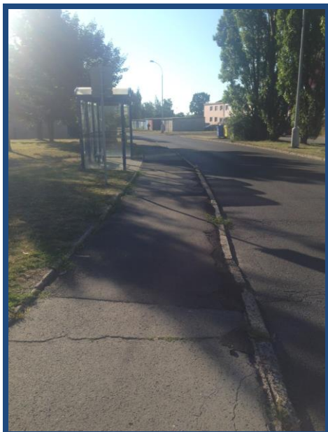
propadlý chodník nad topným kanálem Actherm
