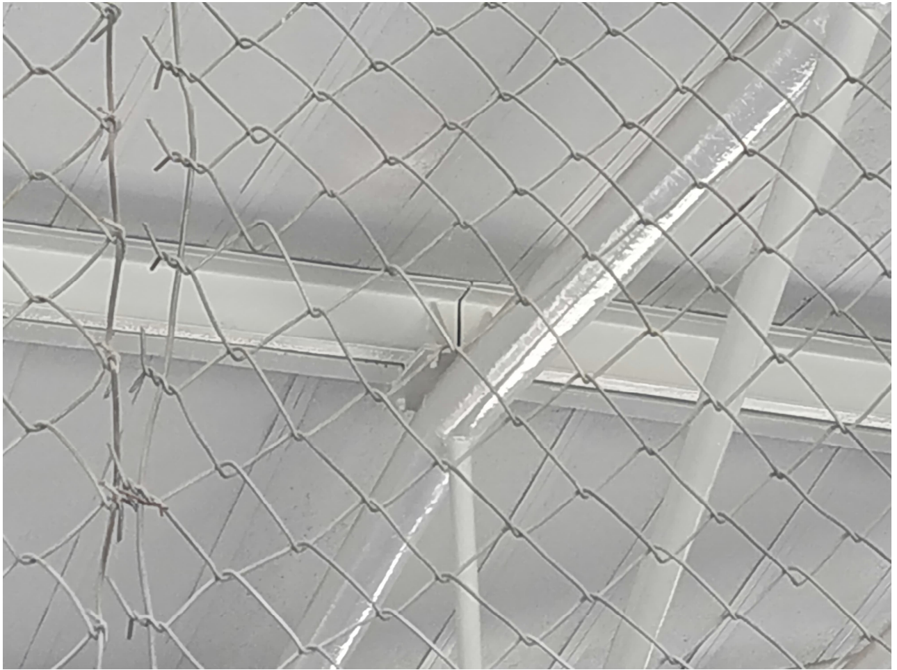
foto č.2 – Vaznice přerušena v uložení na vazník
