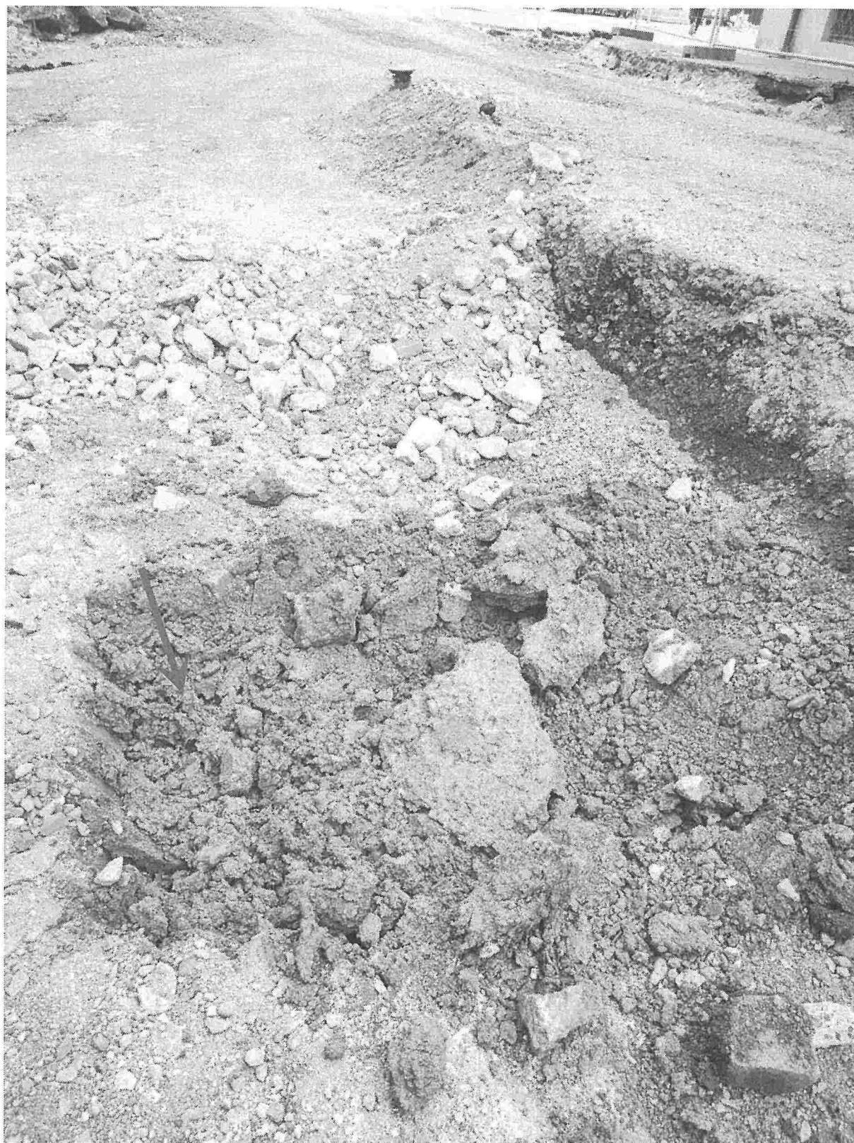
Neúnosné převlhčené navážky v místě SZZ č. 4
