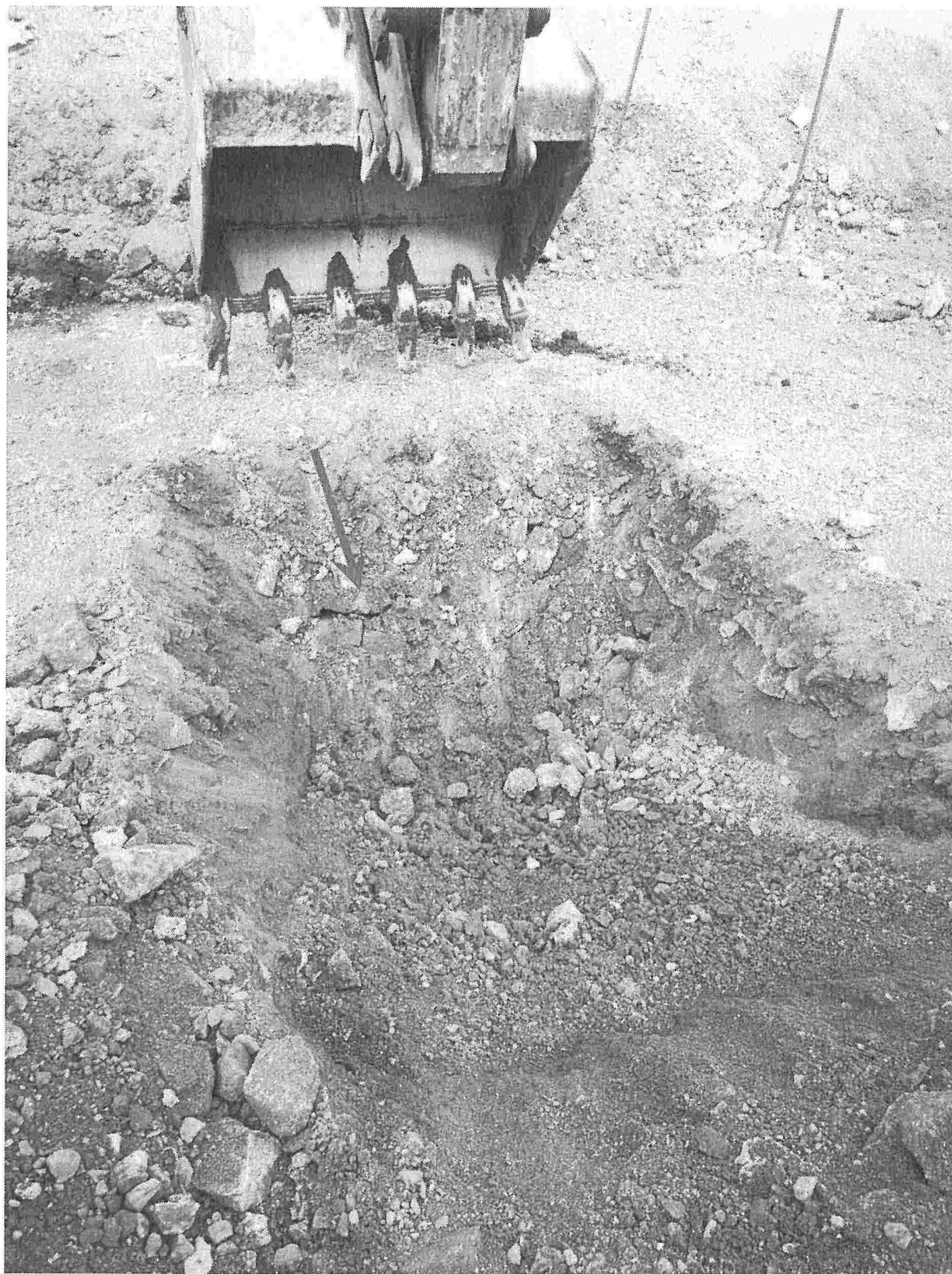
Neúnosné navážky + vyskládané cihly v místě SZZ č. 5
