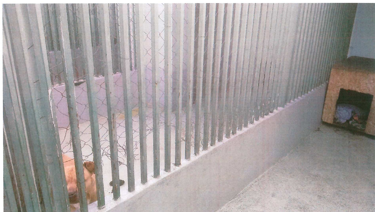
Poškozené pletivo mezi kotci
